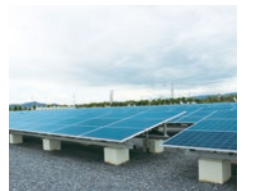
BANDO eco moving 足利太陽光発電所の太陽光パネル
