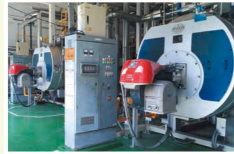
高効率ボイラーの導入(二国間クレジット)
