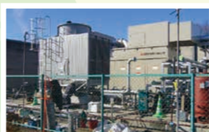
高効率設備への切り替え
