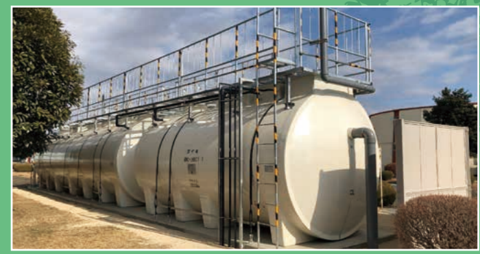
足利工場の新浄化槽
