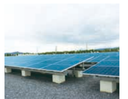
BANDO eco moving 足利太陽光発電所の太陽光パネル
