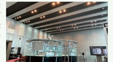
本社事業所に設置したLED照明
