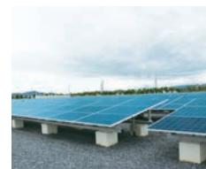
BANDO eco moving 足利太陽光発電所の 太陽光パネル
