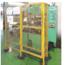
安全柵を設けたプレス加硫設備
