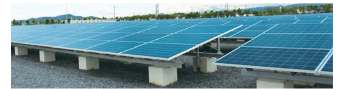
BANDO eco moving 足利太陽光発電所の太陽光パネル
