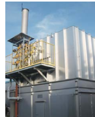
VOC無害化処理装置
