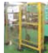
安全柵を設けたプレス加硫設備
