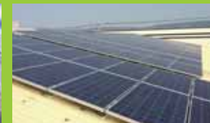
工場屋上に並ぶ太陽光パネル
