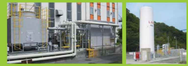
温水吸収式冷凍機 加硫機から出た廃蒸気を熱源に温水を作り熱交換させ冷房を行います
