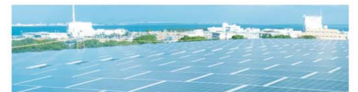
南海事業所の屋上に並んだ太陽光パネル
