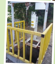
南海工場に設置した油膜検知器
