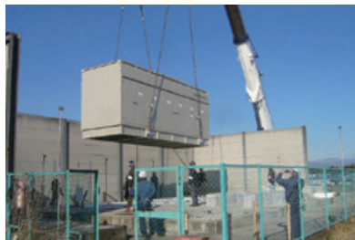
高効率設備への更新
