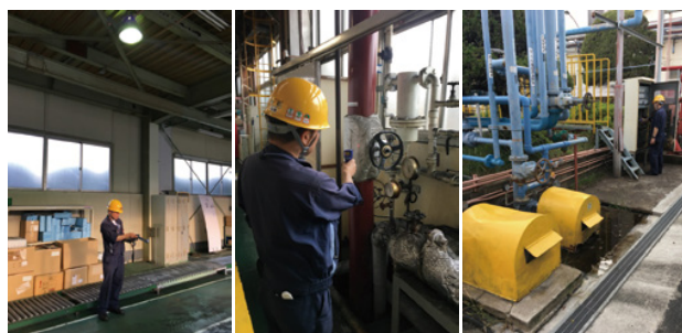
南海工場内（照度測定/温度測定/電力測定）
