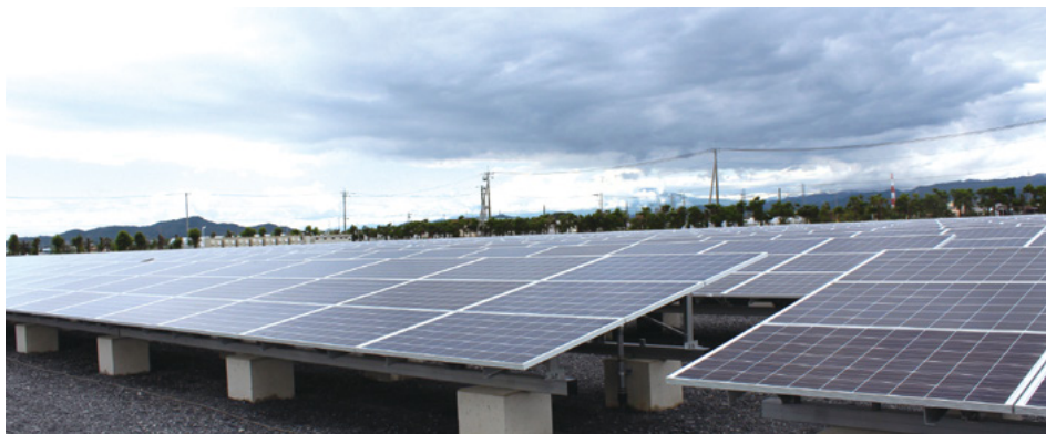
足利太陽光発電所の太陽光パネル
